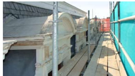
Dakkapel met houten passtukken aan de zijkant die zijn gerestaureerd, de dakkapelen zijn geïsoleerd en voorzien van nieuwe zijwangen
